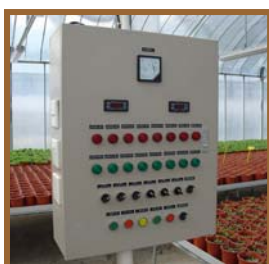
環控設施控制板
