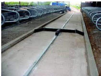
27. 自動刮糞系統 用於清除禽畜廢物。
