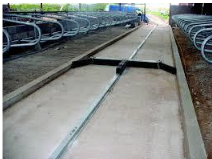
27. 自動刮糞系統 用於清除禽畜廢物。
