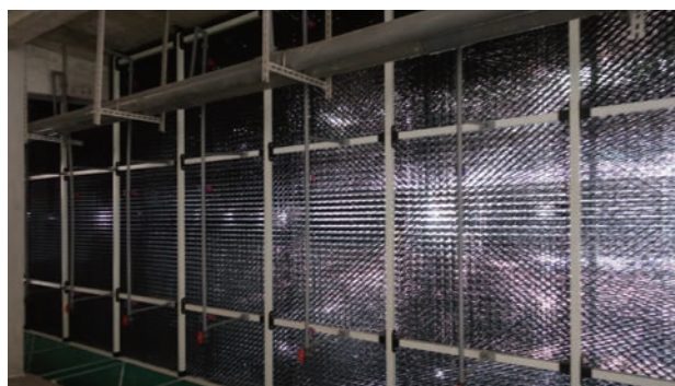
除臭排氣處理系統
