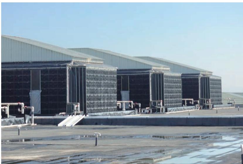
頂樓排氣除味系統
