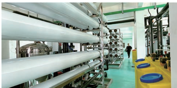
污水處理系統
