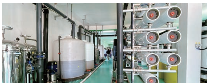
東源東瑞 - 污水處理設備
