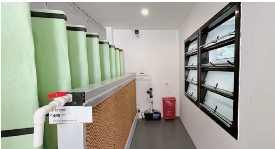
初效過濾牆及水簾系統
