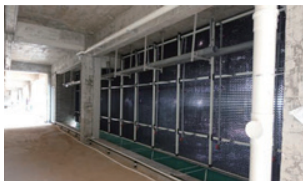
除臭排氣處理系統
