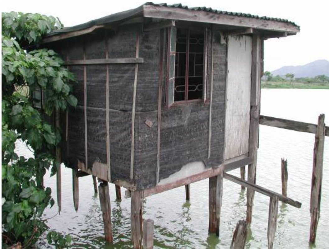
照片五 在基圍旁有待維修的小屋（攝於2006年維修前）
