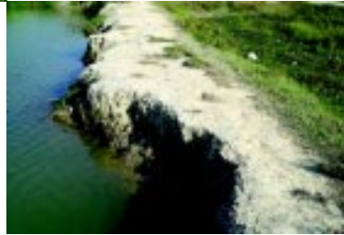
沙質土壤，塘水容易流走。而沙質多的塘壘，容易滲漏坍塌
